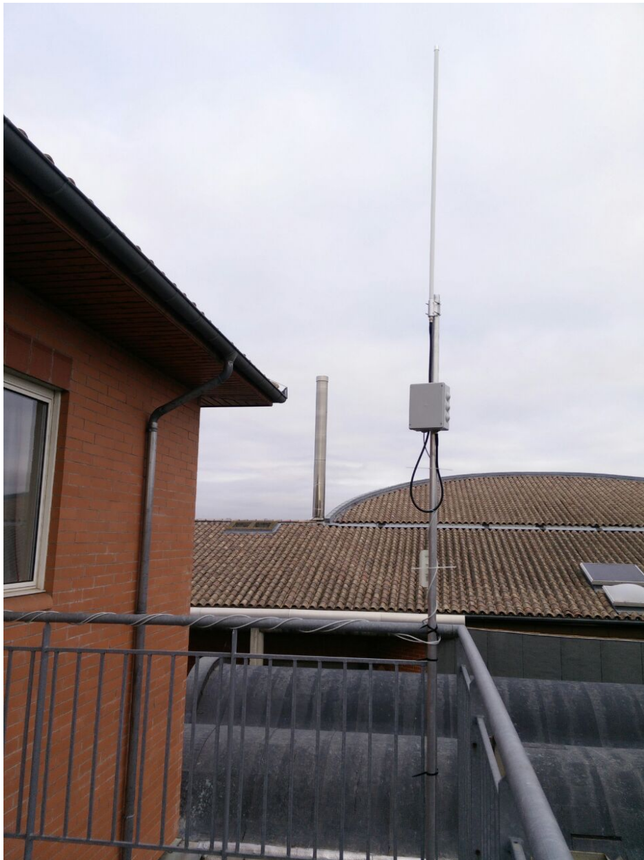
FIGURE 4.6 – Gateway LoRa sur le toit de l'IUT de Blagnac
