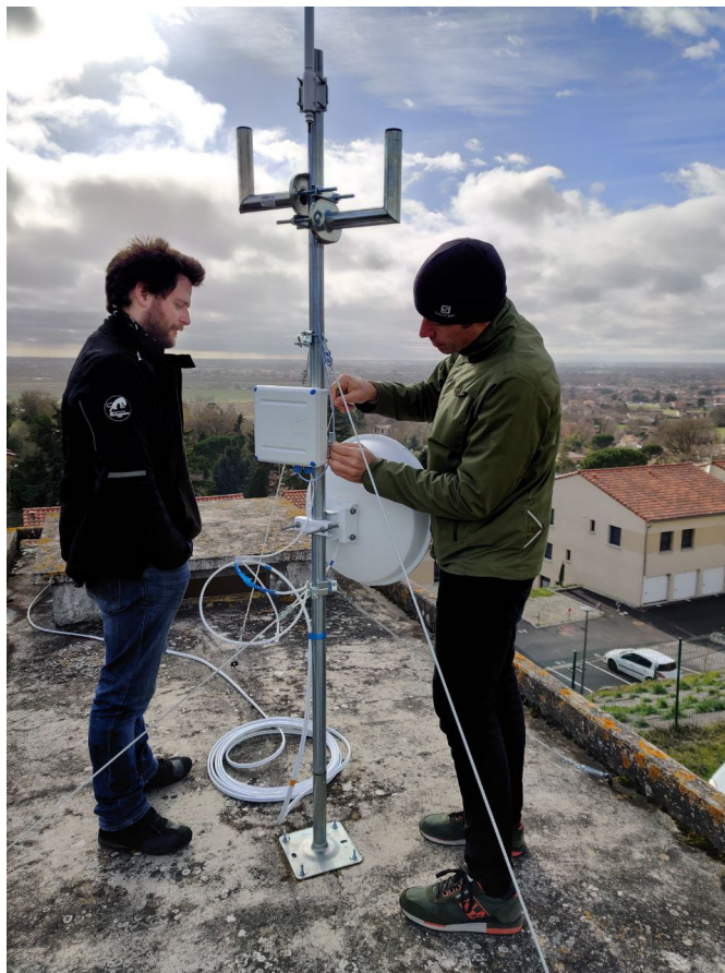
FIGURE 3.3 – Exemple d'installation d'une antenne LoRa sur un toit de Toulouse
